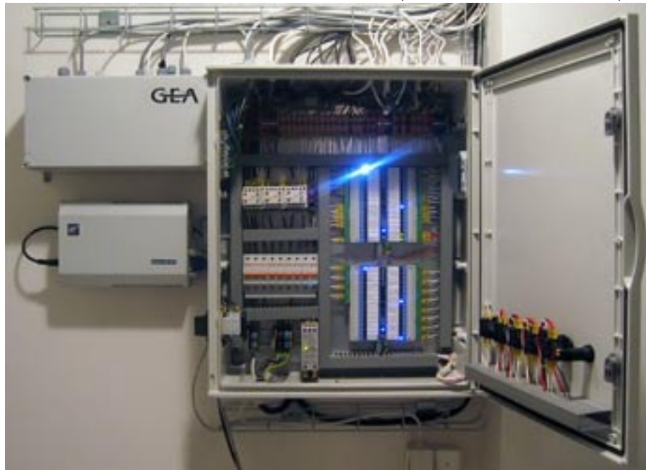
Řídicí systém je rozměrově a energeticky úsporný
