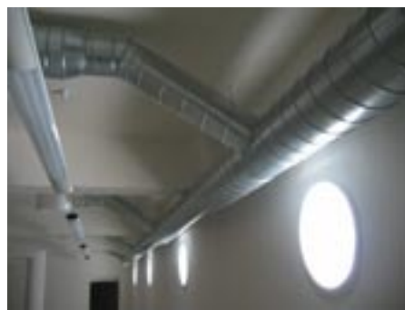
Rozvody upraveného vzduchu
