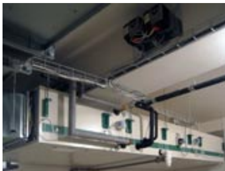
Filtroventilačních a klimatických jednotek
