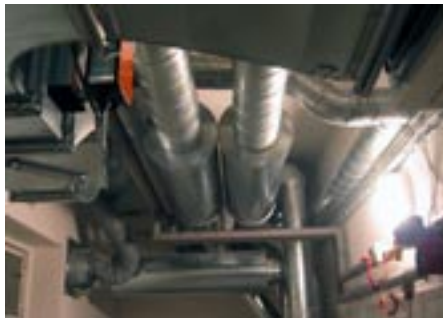
Rozvody vzduchu a topné vody ve strojovně
